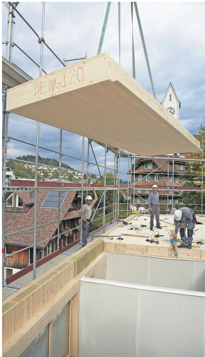
Arbeiten am Vorzeigeprojekt der Alpnacher Firma Küng in Kriens – dem Plus-Energiehaus. PD
