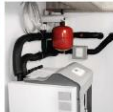
Anschluss der Erbohrde an die Wärmepumpe
