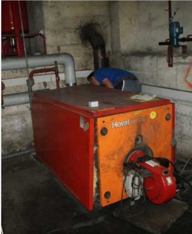
Quelle: Kurs der Kantone Luzern/Aargau „Heizungs-Check“
